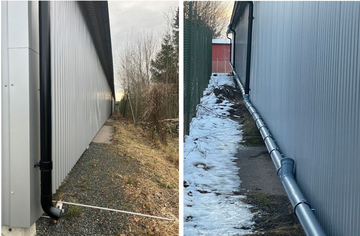
Före och efter. Vatten från utkastarna på carporten har samlats upp i rör. Dessa ska sedan anslutas mot stenkistan.
