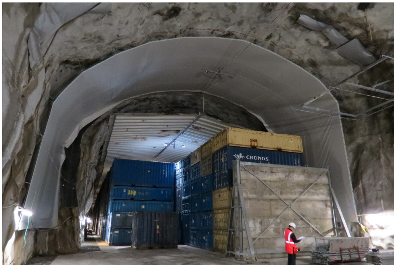
Tak och tunnelduk i 1BLA
