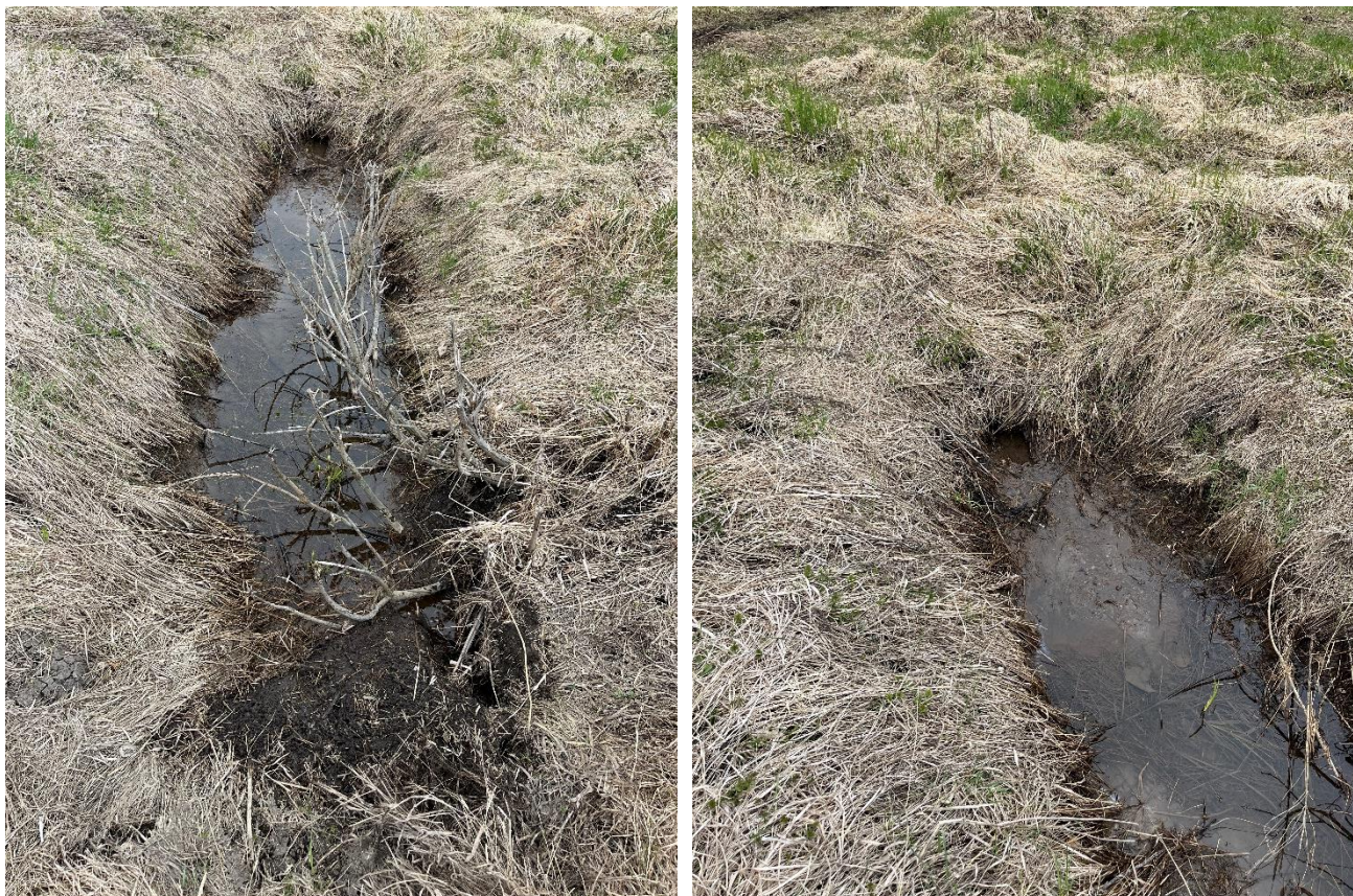
Figur 11. Bild tagen på platsbesök 2024-04-22. Del av dike och trummor. Erosion troligen från åkermark.
