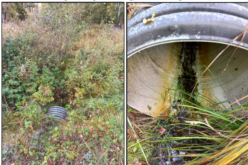
Figur 9. Befintlig trumma beläget i norra delen av utredningsområdet. Inlopp vid befintligt dike och leder vattnet vidare ut i Ångsfjärden.
