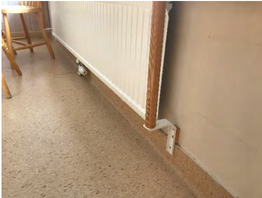
Radiator med termostad
