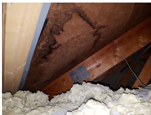
Takets undersida med fuktskadad masonit.
