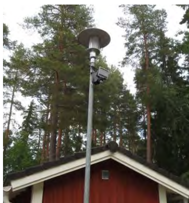
Belysningsstolpe har kompletterats med bländande strålkastare.
