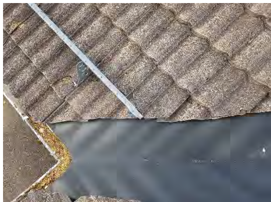
Kapade pannor utan upplag samt igensatt hängränna.
