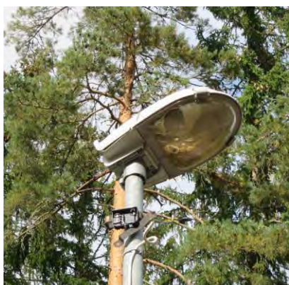
Trasig stolpbelysning av äldre typ, bör ersättas av LED-armatur med inbyggd nattsänkning.
