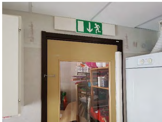
Kasthake på dörr till utrymningsväg.
