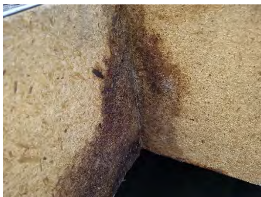
Fuktskada/läckage på ram till takluckan.
