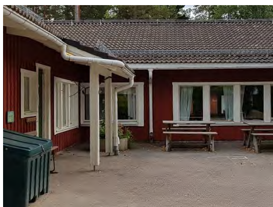
Stuprör vid skärmtak.
