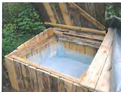
Figur 12. Fekalier från en urinsortering torrtoalett kan tas hand om på den egna tomten, genom kompostering i en latrinkompost.
