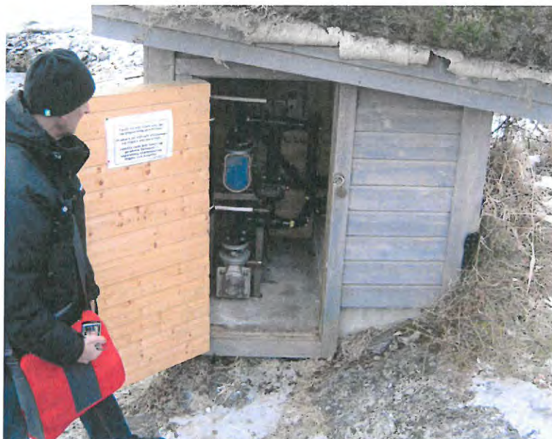
Figur 13. Vakuumstationen kan inrymmas i en betongbrunn eller en liten isolerad bod. Vakuumstationen på bilden ligger vid Engskaret i Norge och har två vakuumaratorer som arbetar växelvis och vid behov tillsammans. Foto: D. Stråe.
