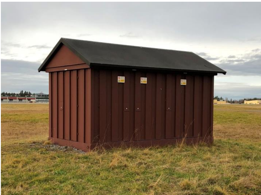
Figur 2.1.2.3. Exempel på en transformatorstation.
