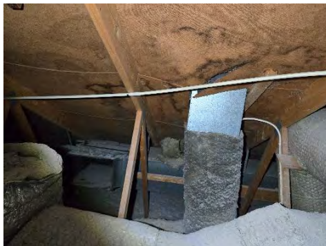
Foto 12 Fuktgenomslag vid ventilationshuv
