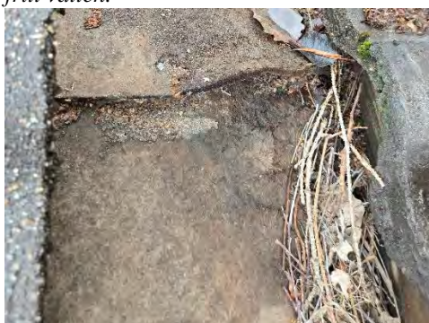
Foto 16 Skräp under betongpannor, masonitskiva uppfuktad och svälld.
