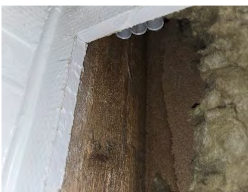
Foto 8 Provpunkt i överkant vägg med rinnmärken. Uttaget prov av trästomme påvisar mikrobiella skador.
