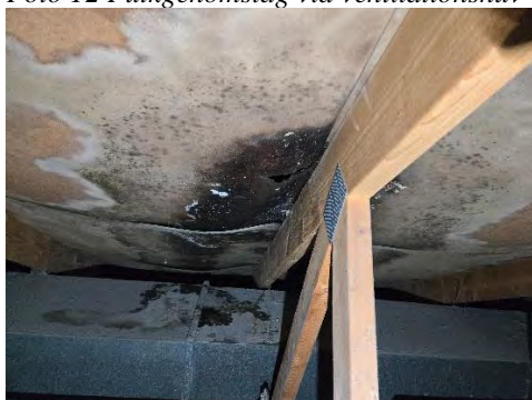
Foto 14 Noteras hål i masoniten. Fuktkvoten > 28\% dvs. fritt vatten.
