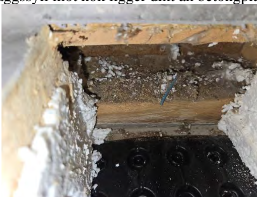
Foto 6 Provhål i korridor mot kök. Platonmatta installerad, dock ligger innerväggssyll direkt på betongen. Analys påvisar förhöjda halter mikroorganismer.
