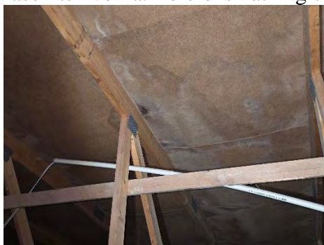
Foto 9 Fuktgenomslag genom masonitskivorna. Fuktkvoter >28 % uppmättes i masoniten dvs fritt vatten. V
