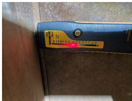
Foto 10 Fuktkvotmätning i takstol under fuktgenomslag, ca 20 % uppmättes dvs. över kritisk nivå för mikrobiell tillväxt.
