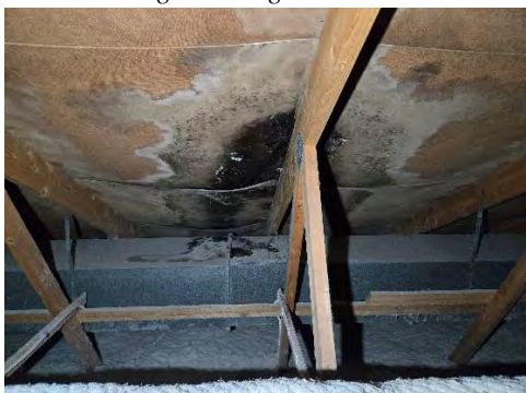
Foto 13 Fuktskadad masonit med tydliga läckage
