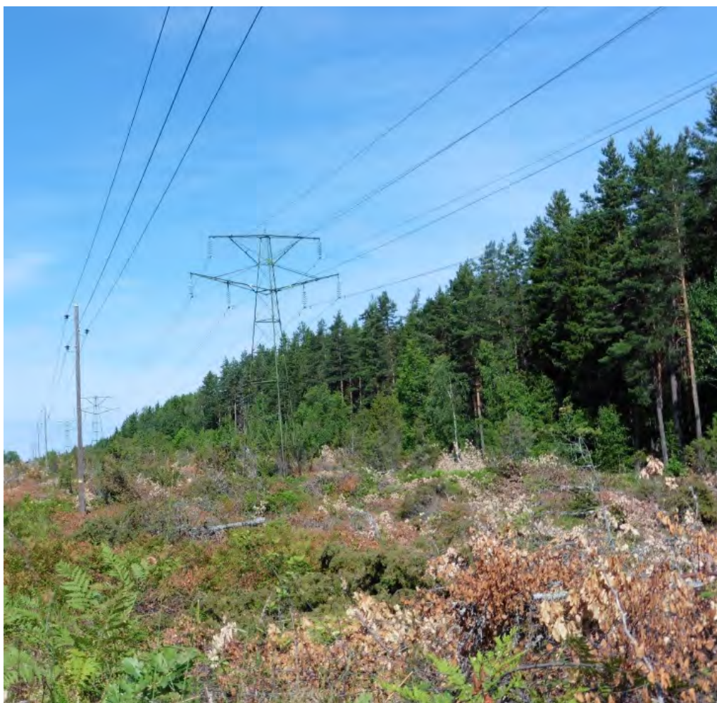
Figur 9. Befintlig 70 kV ledning parallellt med 20 kV ledning i sektion 2.
