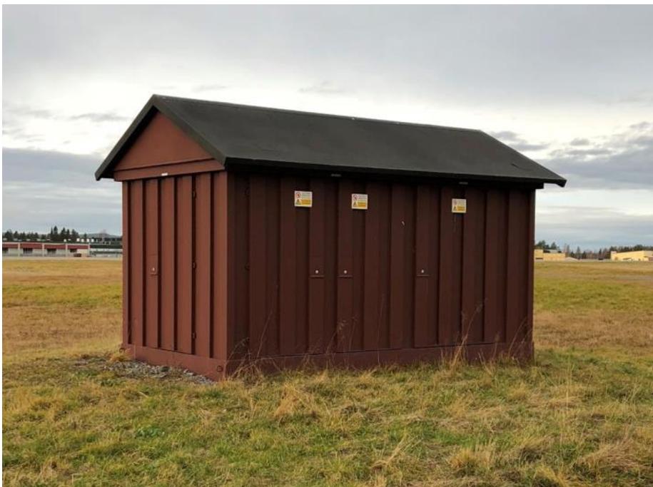
Figur 2.1.2.3. Exempel på en transformatorstation.
