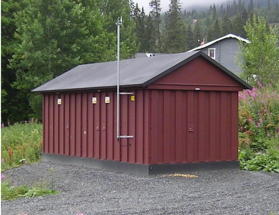
Figur 2.1.2.2. Exempel på en kopplingsstation.
