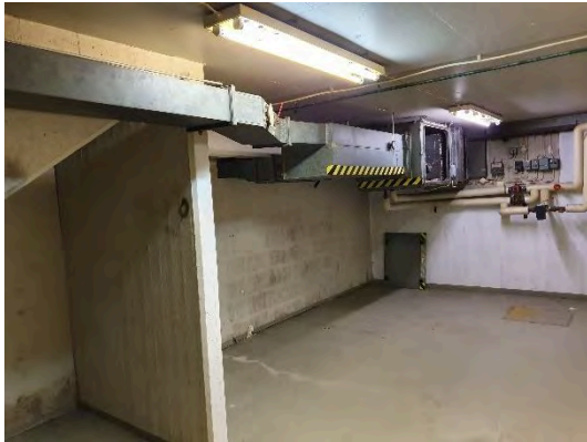
Rum under lokalen i markplan, ventilation ej i bruk.
