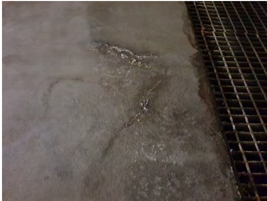
Sprickbildning i golv med saltutfällningar. Rostande ränna med kvarstående vatten med hinna av olja.
