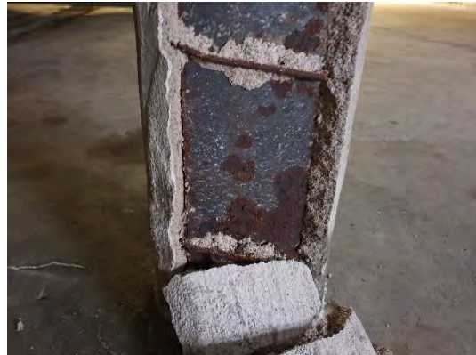
Pelare i H-profil med omfattande rostangrepp, omgivande betong har sprängts loss.
