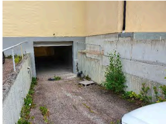
Asfalt i dåligt skick och avledning av dagvatten är bristfällig.
