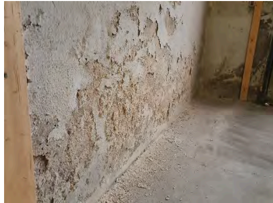
Fuktgenomslag och putssläpp på vägg.
