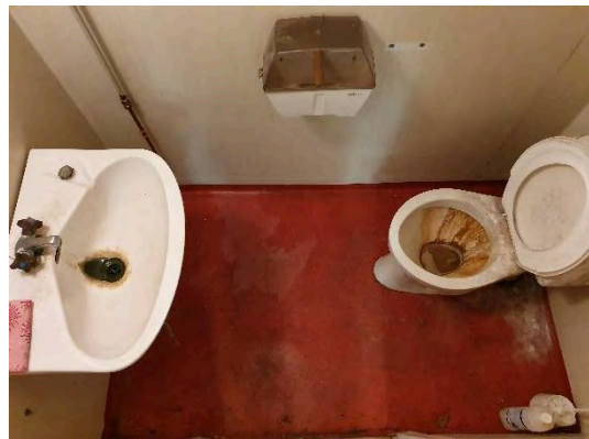
WC med läckande blandare och rinnande WC, fuktskada på golv med fritt vatten.
