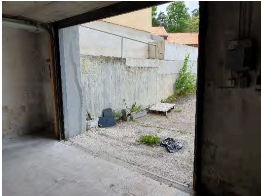
Nedfart till källare.
